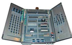
Шкаф системы управления технологическим оборудованием ОАО «Очаковский молочный завод», TetraPak, Москва
