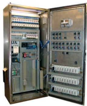
Шкаф системы управления участком МХО ОАО «Белгородский молочный комбинат»
