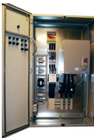
Комплектный шкаф управления задвижками и насосом 160 кВт с преобразователем частоты КОС/ВОС Сургут «ЭКОС-Инжиниринг», Новочеркасск
