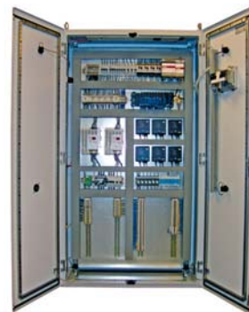
Шкаф система управления CIP-модулем ЛМ5 ОАО «Тольяттимолоко»
