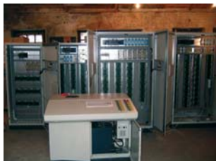
Тестирование шкафов управления драги № 203
