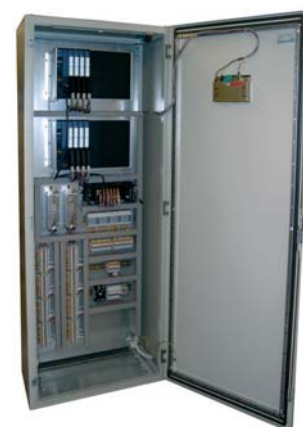
Шкаф системы управления подвижными толкающими конвейерами линий М и R производства чугуна ОАО «КАМАЗ-Металлургия»
