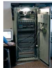
Шкаф управления производством тетрафторметана ФГУП «Ангарский электролизный химический комбинат»
