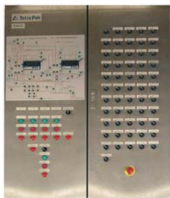
Шкаф системы управления линией по производству соков и пюре фирмы «Сады Придонья», TetraPak, Москва
