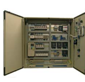
Шкаф системы управления CIP-модулем линии производства и фасовки майонеза ЗАО «Демиург»
