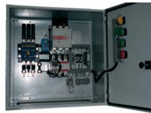
Пусковая и коммутационная аппаратура насосных станций
