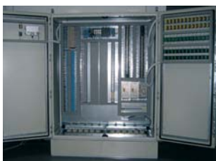
Шкаф управления узлом обратной закачки АК «АЛРОСА»
