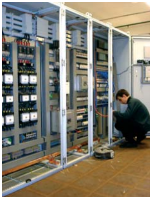
Система управления битумным хранилищем миксерного отделения завода по производству кровли ОАО «Стройлин», Минеральные воды
