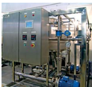
CIP-модуль ЛМ3 ОАО «Челябинский городской молочный комбинат» со шкафом управления Festo «Техноком», Электросталь, Московская область
