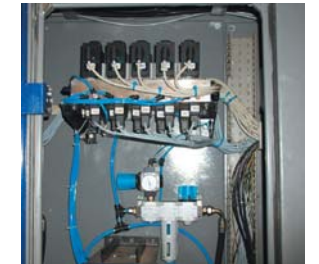
Шкаф управления рельсошлифовального поезда ОАО «Калужский завод «Ремпутьмаш»
