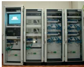
Серверное и телекоммуникационное оборудование АСУ ТП электролиза фтора ФГУП «Ангарский электролизный химический комбинат»
