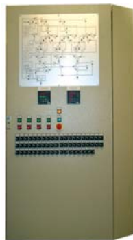
Шкаф системы автоматизации производства субстанции препарата «Витанам» ОАО «Московский дрожжевой завод «Дербеневка»
