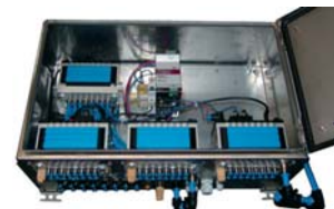
Пневмо-шкаф системы управления участком приемки и хранения молока ОАО «Белгородский молочный комбинат»
